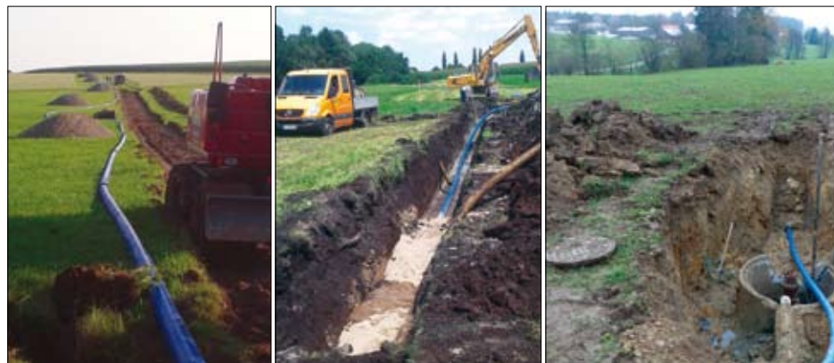
Die Bilder zeigen (von links) Leitungserneuerungen in Albers (bei Bad Wurzach), Münchenreute (bei Aulendorf) und Unterhalden (bei Hauerz). Fotos: bfr
